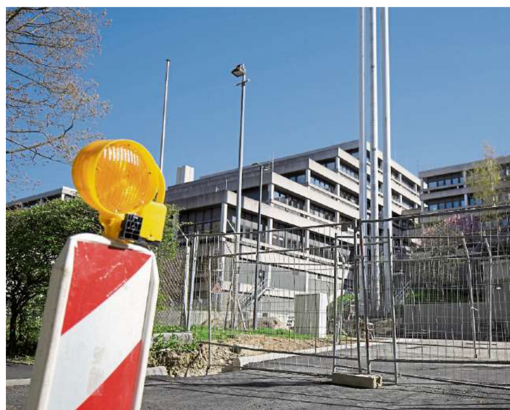
Die Baustelle am Bundeskriminalamt vom Tränkweg aus gesehen. Die Sanierung hat im Februar begonnen. Foto: Sebastian Stenzel
